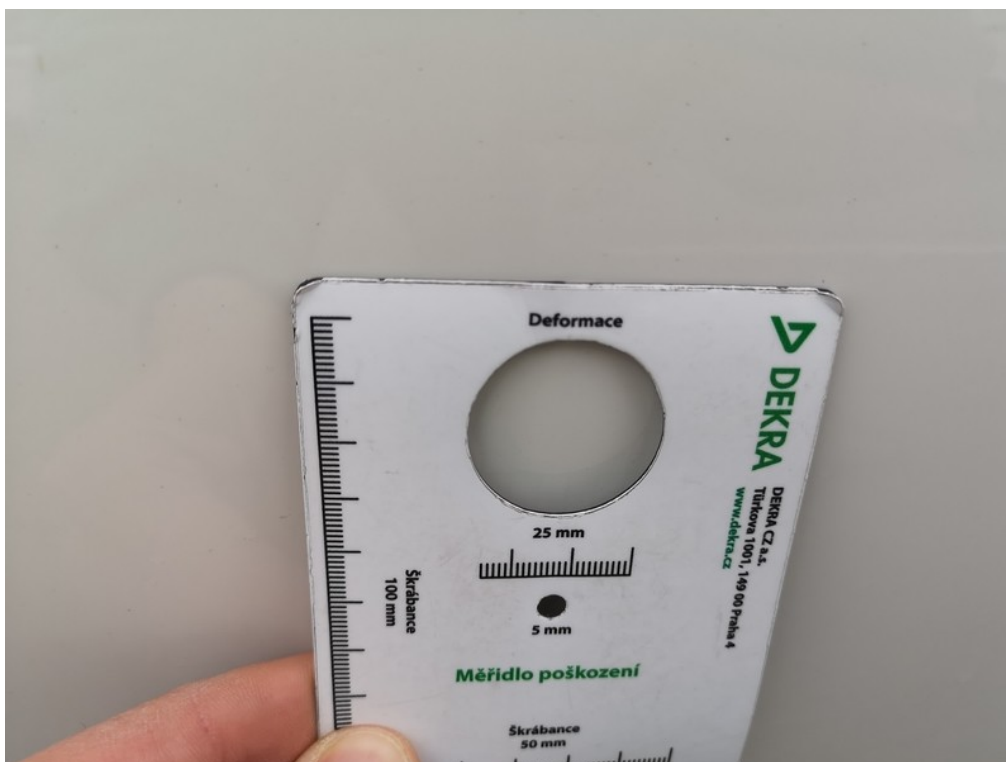
Viz popis k poškození č. 14
