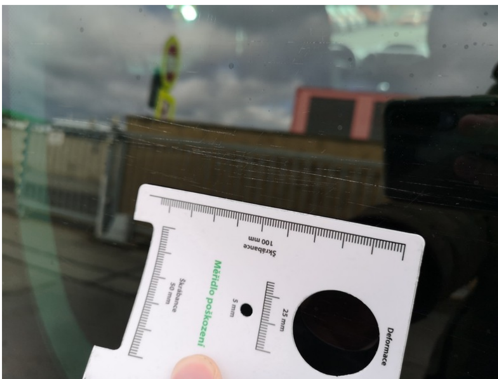
Viz popis k poškození č. 7
