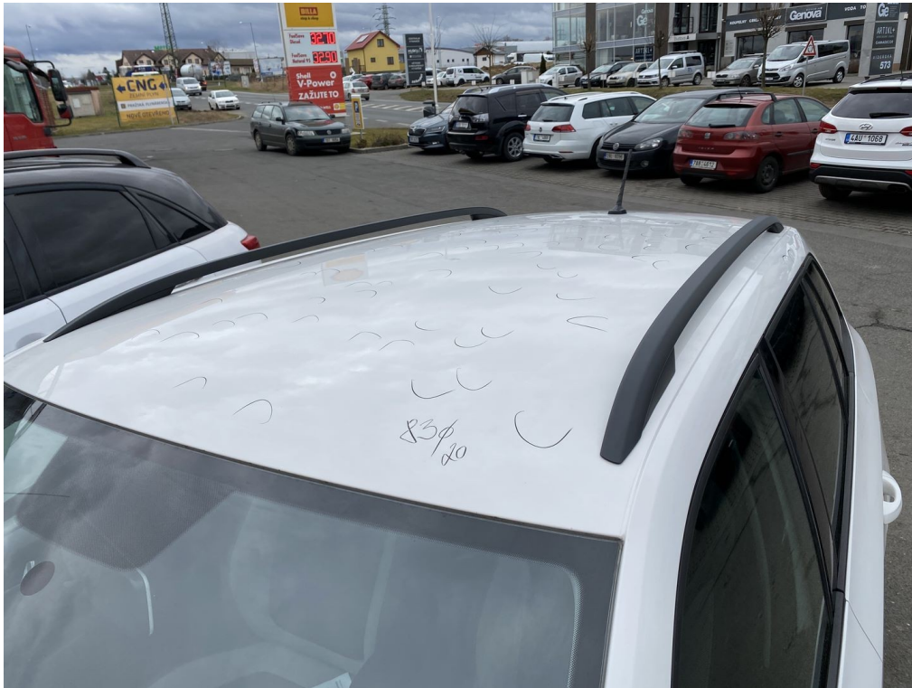
Viz popis k poškození č. 2
